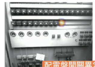
配電盤開關異常
